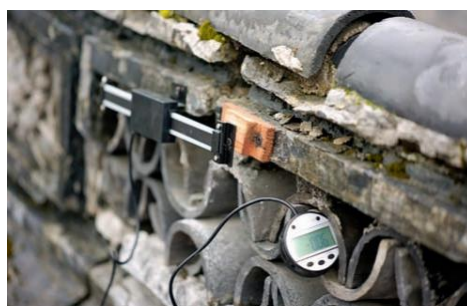
图 23 屋脊裂缝测量
